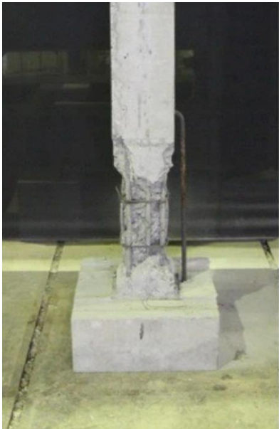
เสาที่ได้รับ ความเสียหาย
